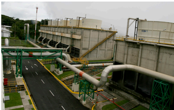
Alfredo Huerta Proyecto Geotérmico Miravalles I, ICE
