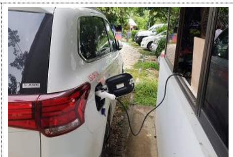
Recarga de vehículos híbridos
