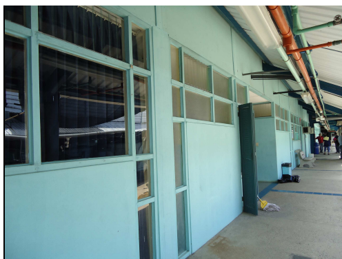
Fotografía 5. Estado de los Pasillos y área comunes de la Estación de Biología Marina
