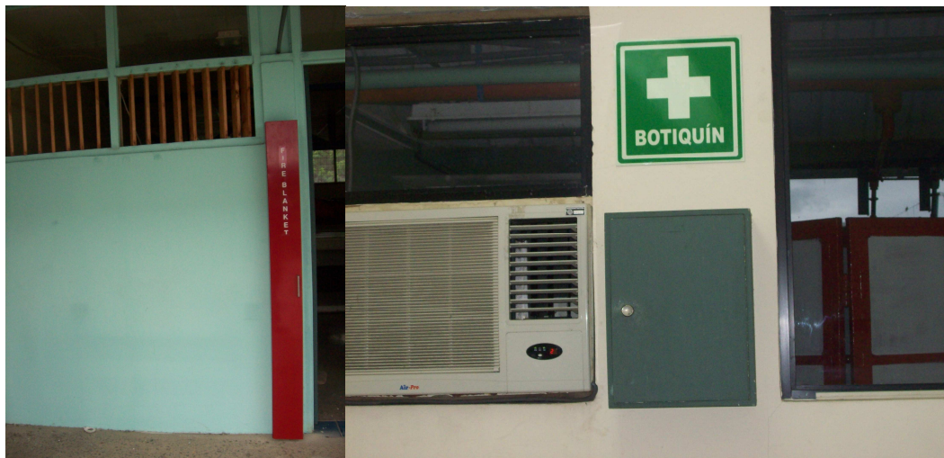
Fotografía 10. Rótulos y manta contra incendio de la Estación de Biología Marina
