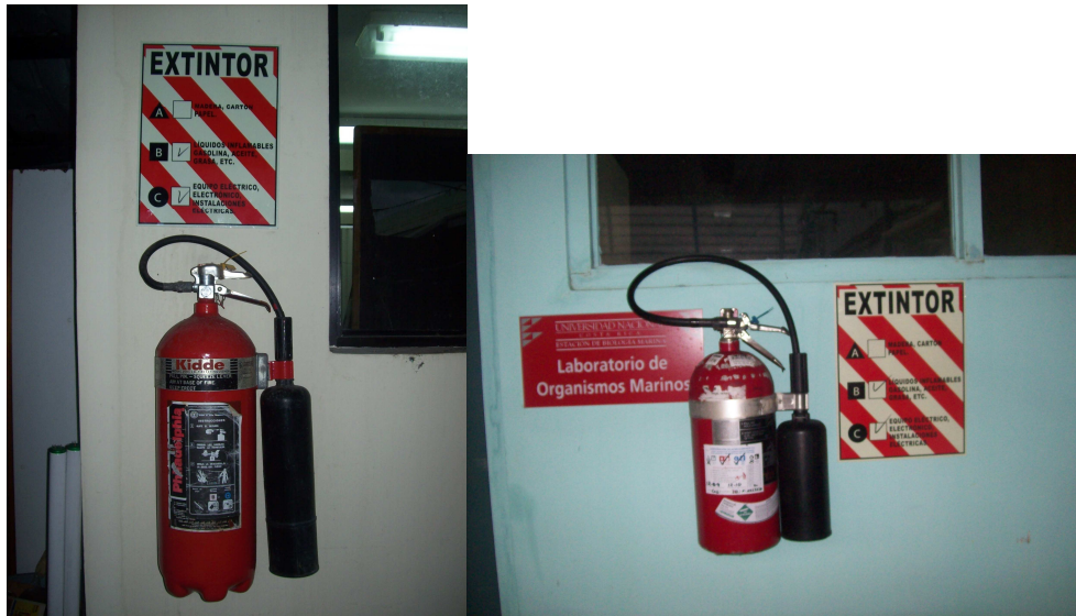
Fotografía 9. Extintores de la Estación de Biología Marina
