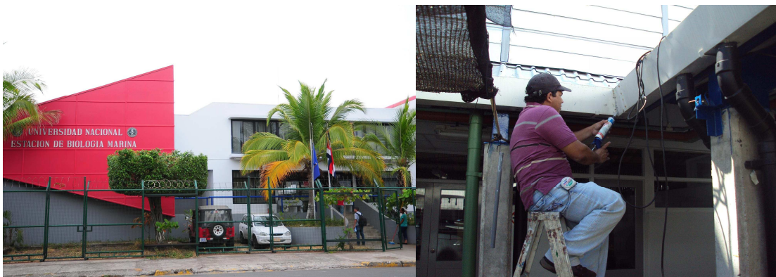
Fotografía 1. Mejoras en los edificios de las Facultades de la Estación de Biología Marina en Puntarenas.
