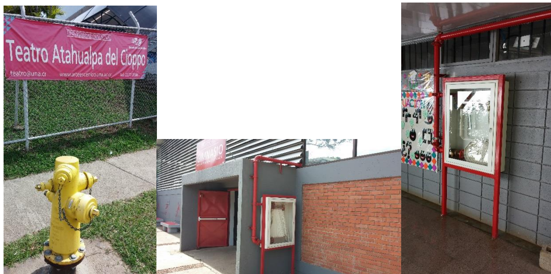
Figura 37. Fotografías de dispositivos para la atención de incendios existentes en varios puntos del Campus Omar Dengo. Proyecto Complejo Artístico y Deportivo Campus Omar Dengo, 2015. Fuente: Geocad, 2015.
