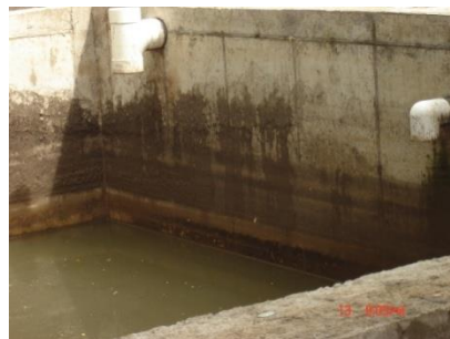
Figura 15. Tanque de homogenización. PTAR-UNA. Proyecto Complejo Artístico y Deportivo Campus Omar Dengo, 2015.
