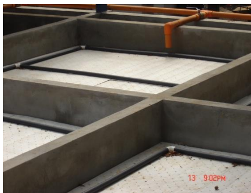
Figura 19. Lechos de Secado. PTAR-UNA 6 . Proyecto Complejo Artístico y Deportivo Campus Omar Dengo, 2015.
