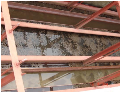
Figura 17. Sedimentadores. PTAR-UNA 6 . Proyecto Complejo Artístico y Deportivo Campus Omar Dengo, 2015.
