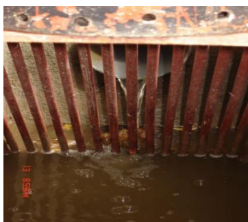
Figura 14. Sistema de rejillas-PTAR-UNA 6 . Proyecto Complejo Artístico y Deportivo Campus Omar Dengo, 2015.
