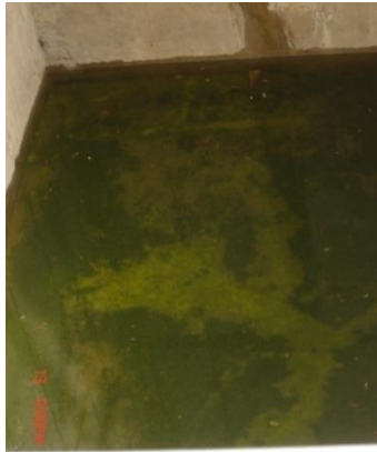
Figura 18. Digestor de Lodos. PTAR-UNA 6 . Proyecto Complejo Artístico y Deportivo Campus Omar Dengo, 2015.
