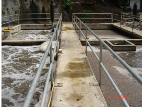
Figura 16. Tanques de aireación. PTAR-UNA 6 . Proyecto Complejo Artístico y Deportivo Campus Omar Dengo, 2015.
